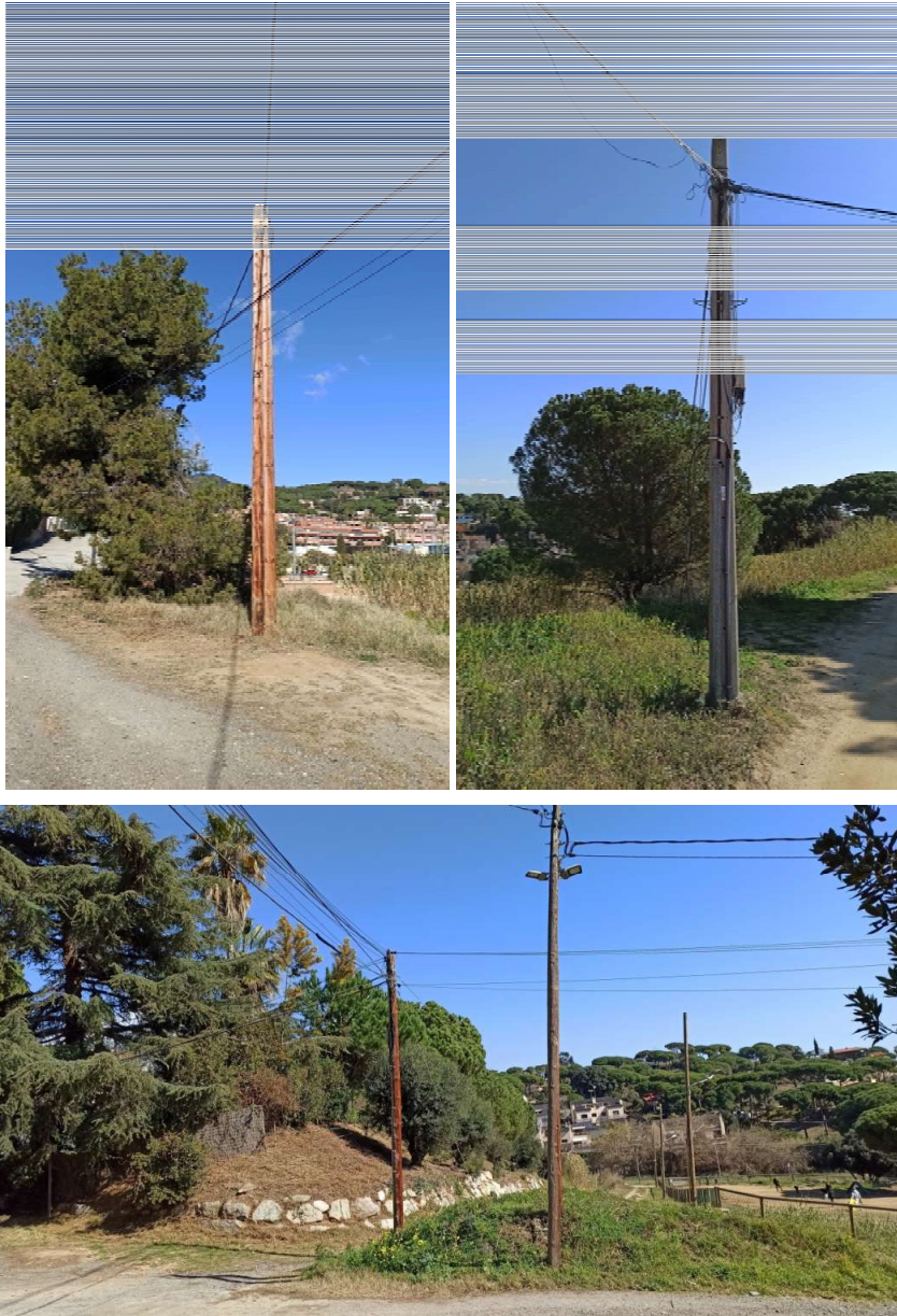
Imatge 33. Fotografies de la xarxa elèctrica i telefònica
